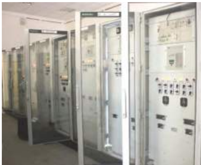
Рис. 1. Микропроцессорное оборудование РЗА
