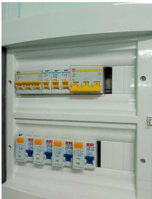
Рис. 5. Автоматический выключатель в электрическом щитке
